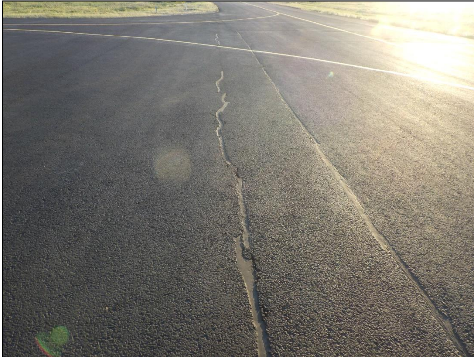
AP21-20: L&T Cracking
