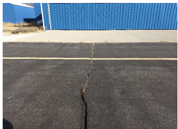
T-5, Transverse Crack
