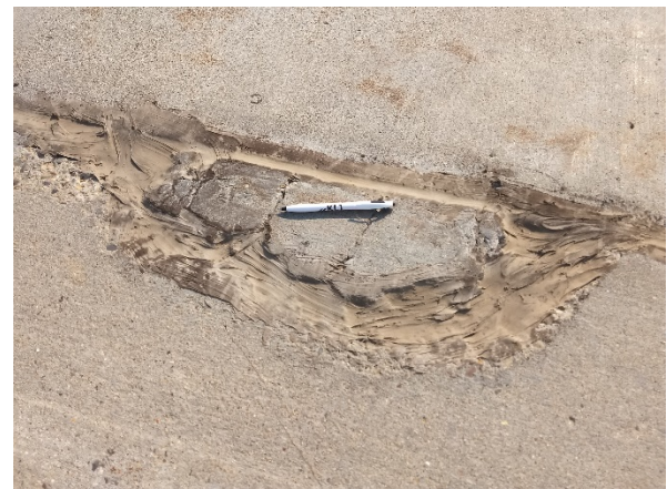
A-6, Joint Spall
