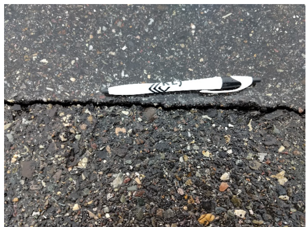
R-1, Longitudinal Crack
